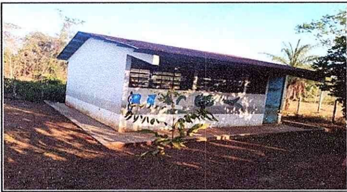
Foto 1: Manetenimiento del techo del edificio Escolar por deterioro
